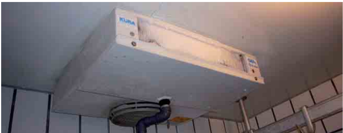
Abtauen! Die Kühlleistung ist wegen Vereisung deutlich beeinträchtigt!
